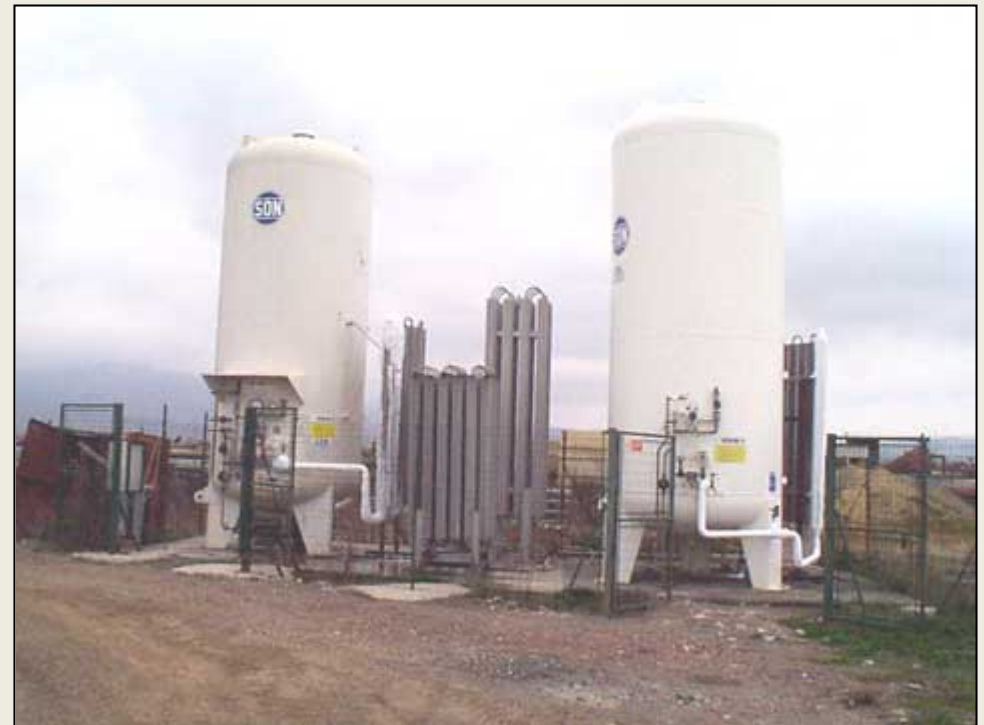
Serbatoi di ossigeno liquido
